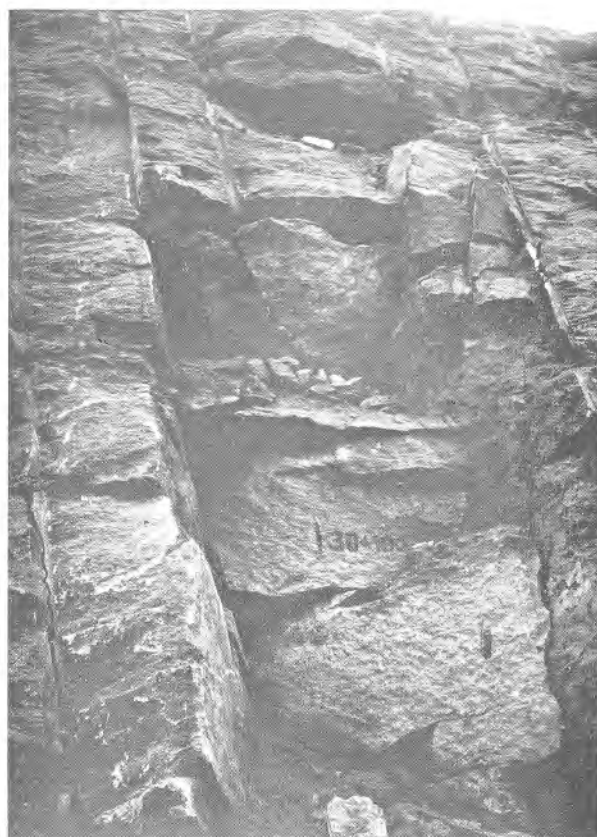
Foto 33.6. Daños producidos en una voladura de precorte por sobrecarga de ésta.
