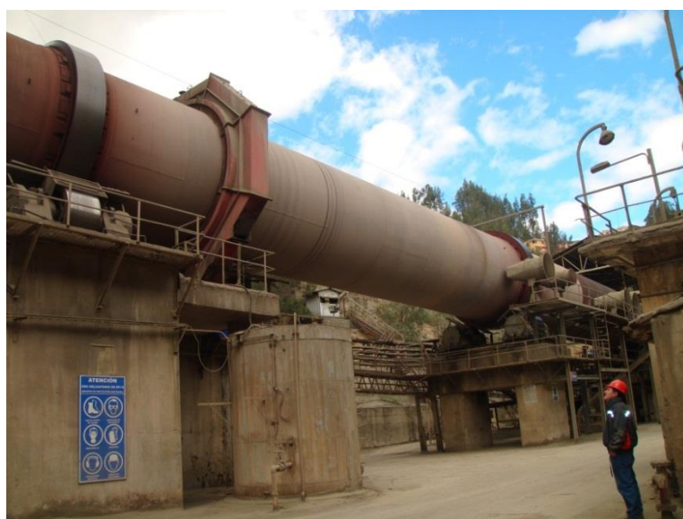
Figura 2.5. Imagen del Horno Rotativo para producción de clinker Fuente: Propia
